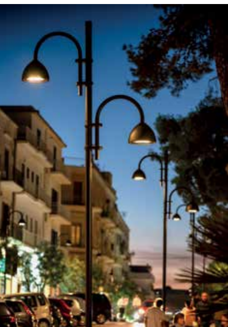
Installazione di lampade Lorelux® a Vieste (FG), a sinistra, e a Sirmione (BS)
